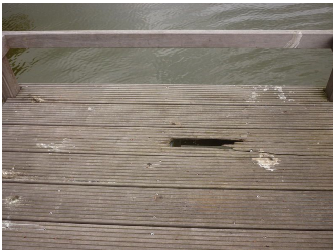
Figuur 3: Schade aan dekplank steiger.
